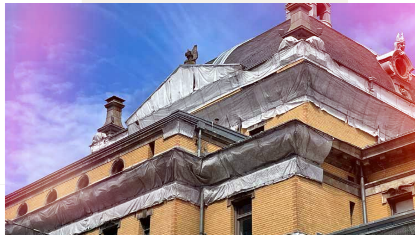
Sikring. Nationaltheatrets fasade må sikres slik at murpuss og bygningsdeler ikke faller ned – på grunn av vedlikeholdsetterlep.
