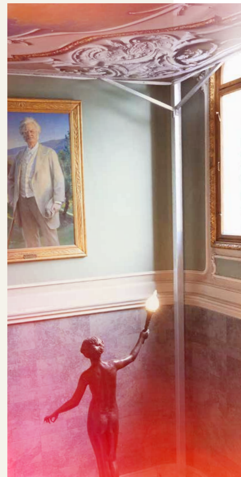
På sommeren 2018 måtte himlingen i marmortrappen mot Karl Johan nedsikres for å forhindre at den kunne skade publikum og ansatte hvis den løsnet. Samtidig sikres det uvurderlige takmaleriet i himlingen for fremtiden.
